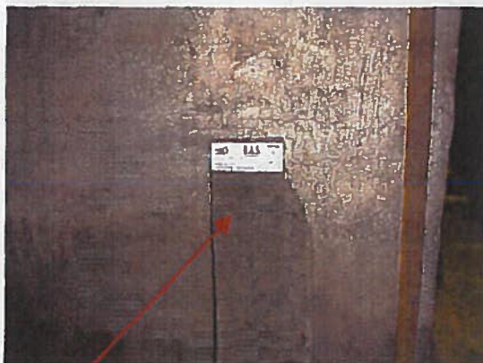
M4 plaatmateriaal bevat 30-60% Chrysotiel
