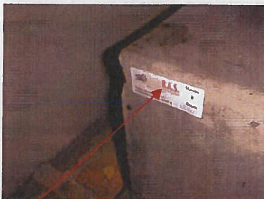
M9 kanaal bevat 15-30% Chrysotiel
