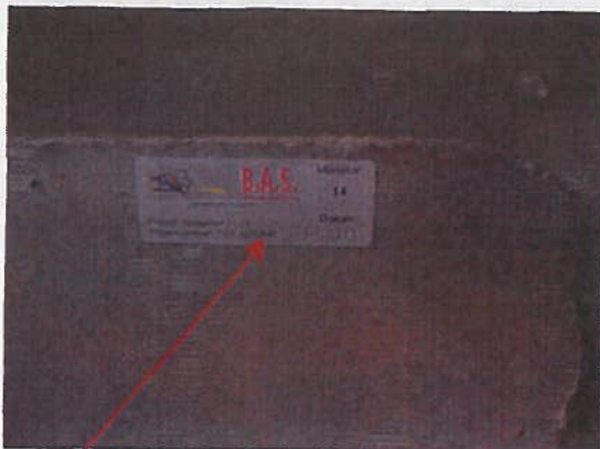
M14 plaatmateriaal bevat 10-15% Chrysotiel
