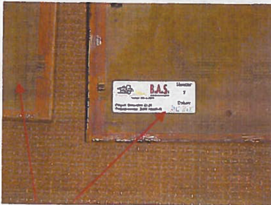
M7 plaatmateriaal bevat 0,1-2% Chrysotiel
