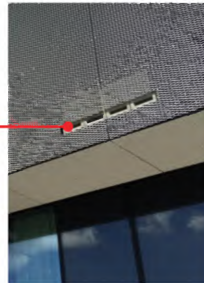
Vleermuiskast achter de gevelbeplating
