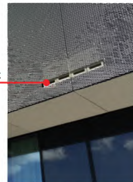
Vleermuiskast achter de gevelbeplating
