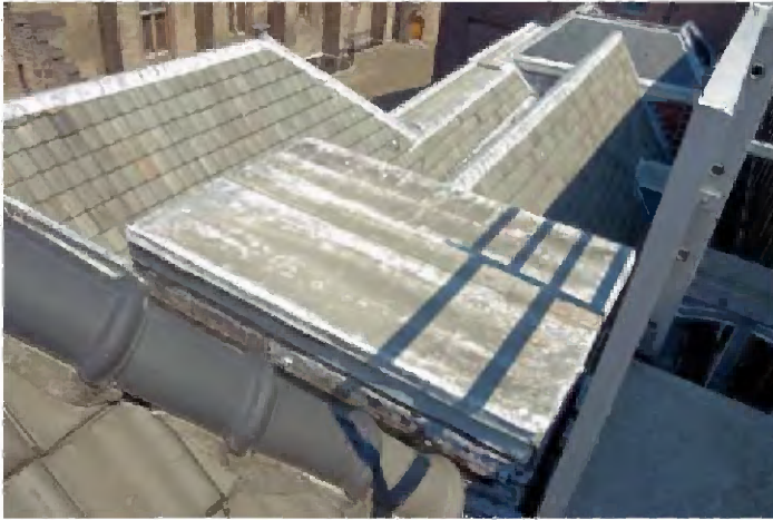
TK-A-789 Samengesteld dak van het Pompegebouw, gezien vanuit het westen richting de Hofpoort en het gebouw Comptoir-Generaal. Links het hogere schilddak van de korte vleugel en rechts (achter het platte dak op de voorgrond) het tweebeukig dak van de lange vleugel, waarbij het linker (noordelijk) deel afgeplat is.
