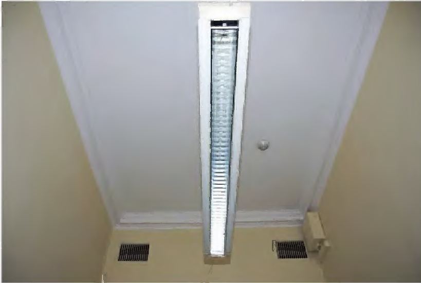
TK-B-94 Stucwerkplafond in B.01.0.09
