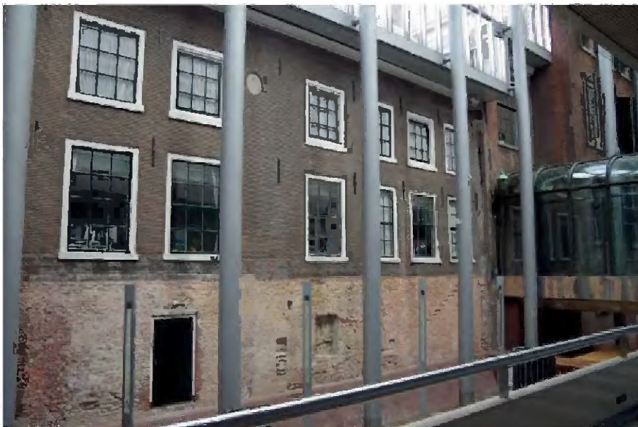
TK-A-788 Zuidgevel. Op kelderniveau een toegangsdeur (boven de hoge voet van de fundering), op de begane grond vensters met roeden schuiframen en op de eerste verdieping vierkante vensters met roeden (tuimel)ramen.
