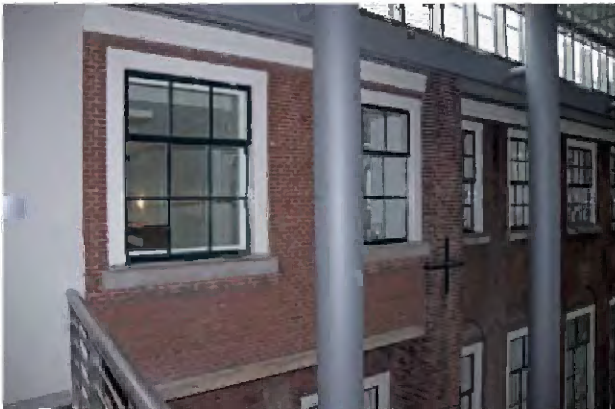
TK-A-705 Overzicht tweede verdieping aan de zuidzijde; van het westelijke smalle deel is de gevel naar voren geplaatst (op betonnen plaat).
