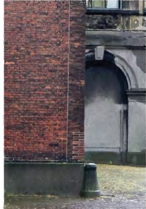
TK-A-697 Zichtbaar is dat de voorgevel (gemetseld uit betere kwaliteit baksteen) voor de bestaande bebouwing is geplaatst. Mogelijk behoort de zijgevel nog tot de oudere, zeventiende-eeuwse fase.
